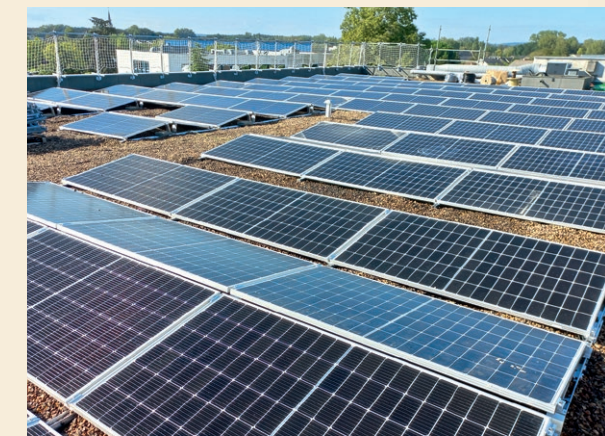
Production d'énergie photovoltaïque sur le toit du collège d'Avoine. (CD 37, 2023)
